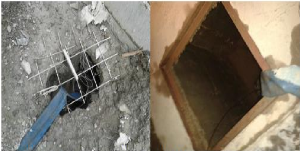
Foto 4 y 5. Vertimientos directos al alcantarillado provenientes del sótano.
